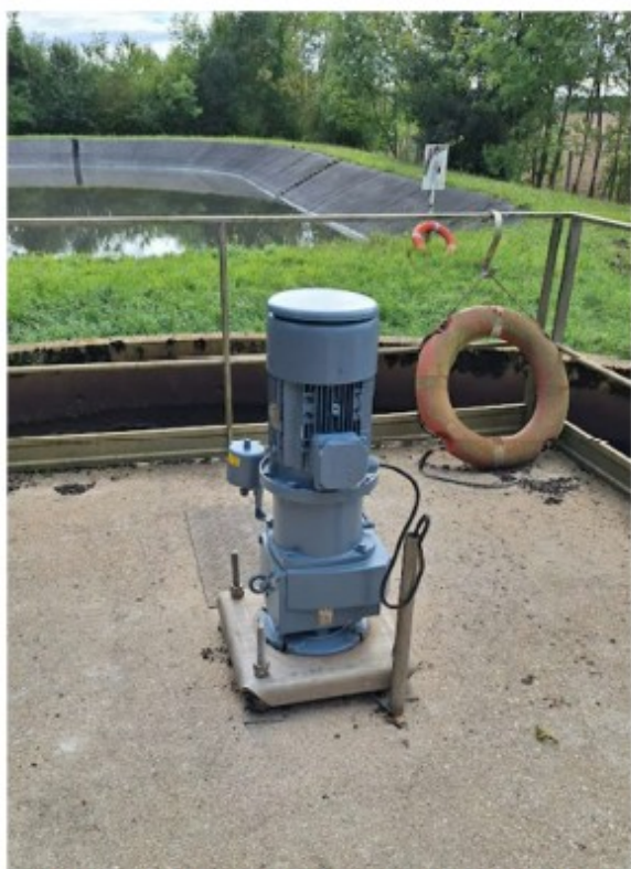
Step de Louvois : Motoréducteur de la turbine d'aération
